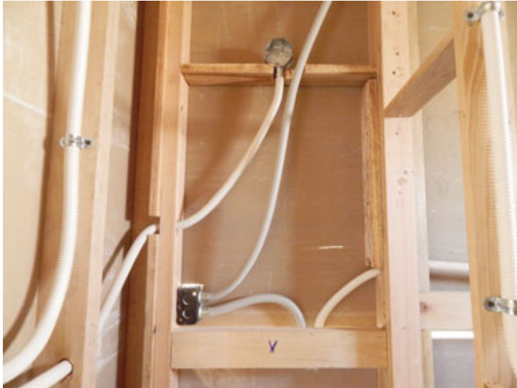
"La parte eléctrica es muy simple. Los listones están cada 40 centímetros y cada uno lleva los caños por donde quiere. Es muy simple. Y está a la vista. El electricista tiene que calcular bien la caja y cuál va a ser el acabado final", señaló el ingeniero.
