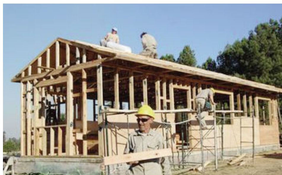
En el Día 2 de trabajo ya se termina con la casa techada. "Tenemos que cerrar la carcasa. Y una vez dado este paso, el propietario ya se puede meter y empezar a vivir", dijo el disertante.
