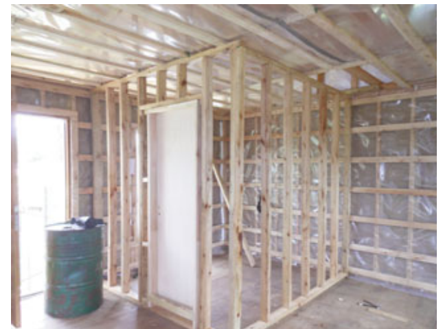
Después de colocar las ventanas se subdivide la casa. Tiene la ventaja de que en un futuro puedo mover las subdivisiones, porque los paneles no son portantes.
