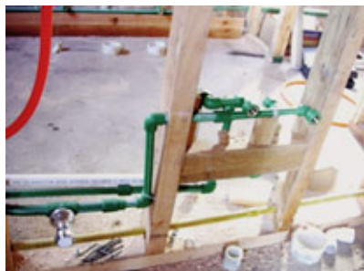
La parte de desagües sanitarios se hace previamente. Y también está confinado a una superficie muy chica.
